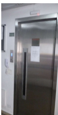
Elevador de serviço
